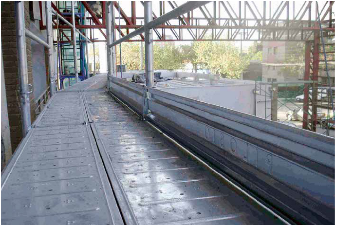
Plataforma de tránsito. Andamio AM72 Fachada. Providencia. 2011
