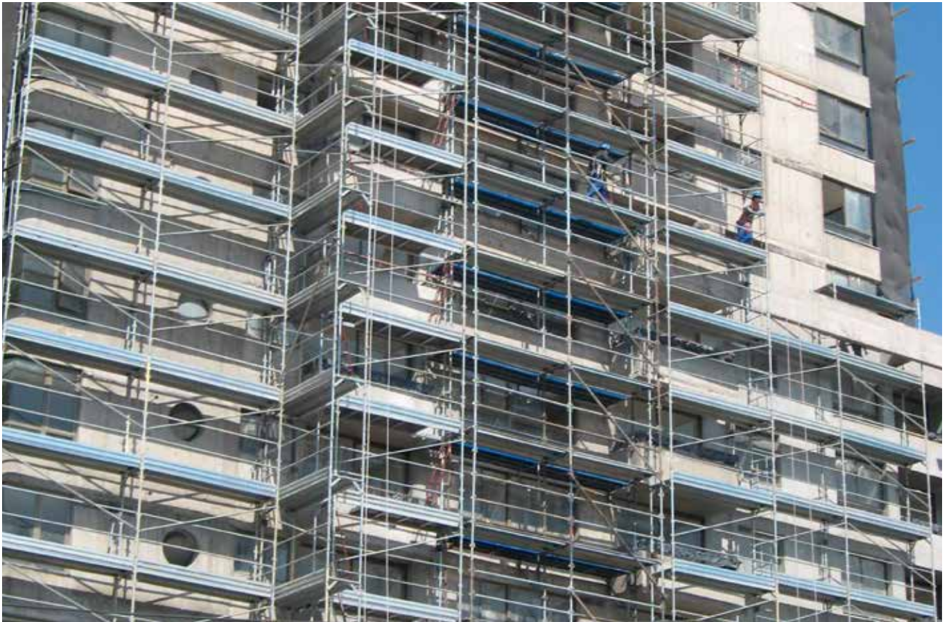
Andamio AM72 Fachada. Ñuñoa. 2016
